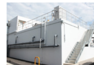
排水リサイクル設備
