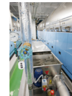
洗濯排水熱交換器
